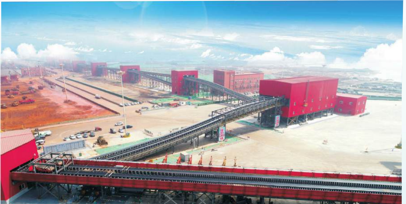
Rizhao limanı Lannan 11 numaralı rıhtımının bantlı konveyör sistemi. Rizhao port Lannan no.11 berth belt conveyor system.
